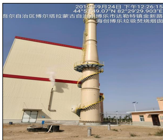
焚烧炉排气筒
