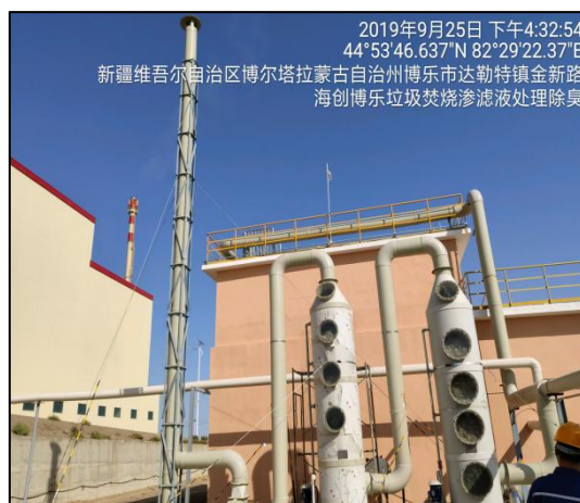
渗滤液除臭装置
