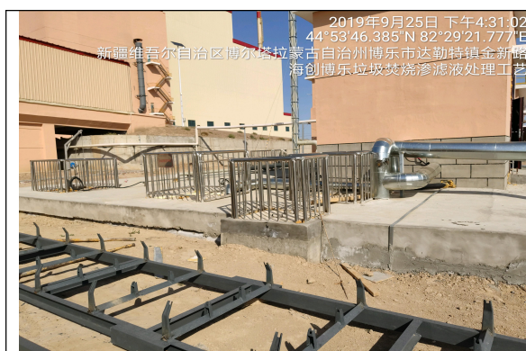
渗滤液处理沉淀池
