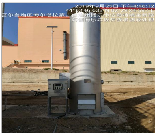
渗滤液处理沼气火炬
