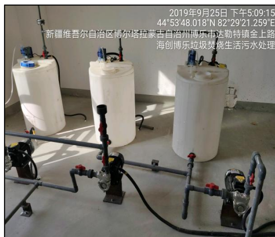
生活污水处理设施
